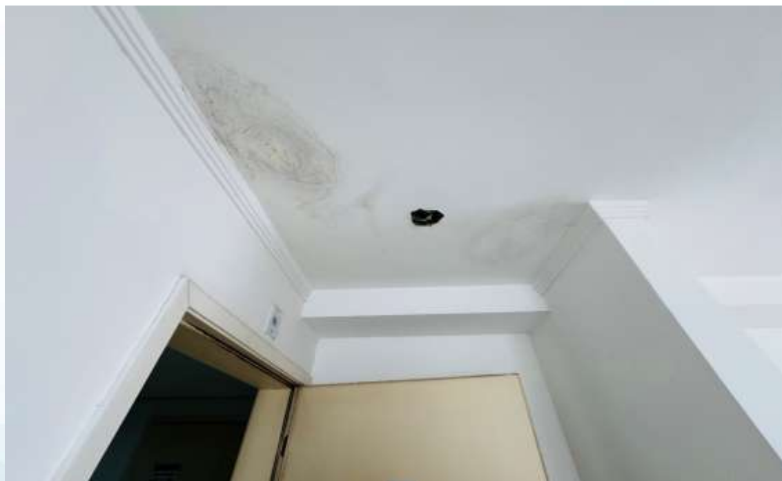
Infiltração em frente a porta de entrada
