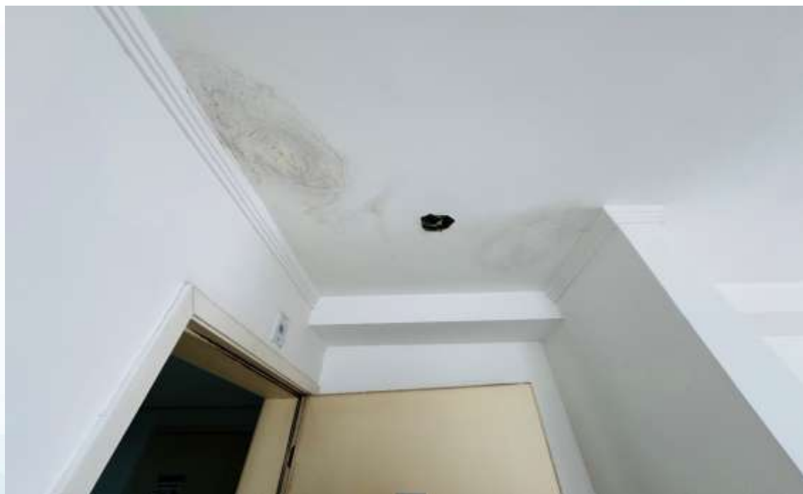
Infiltração em frente a porta de entrada
