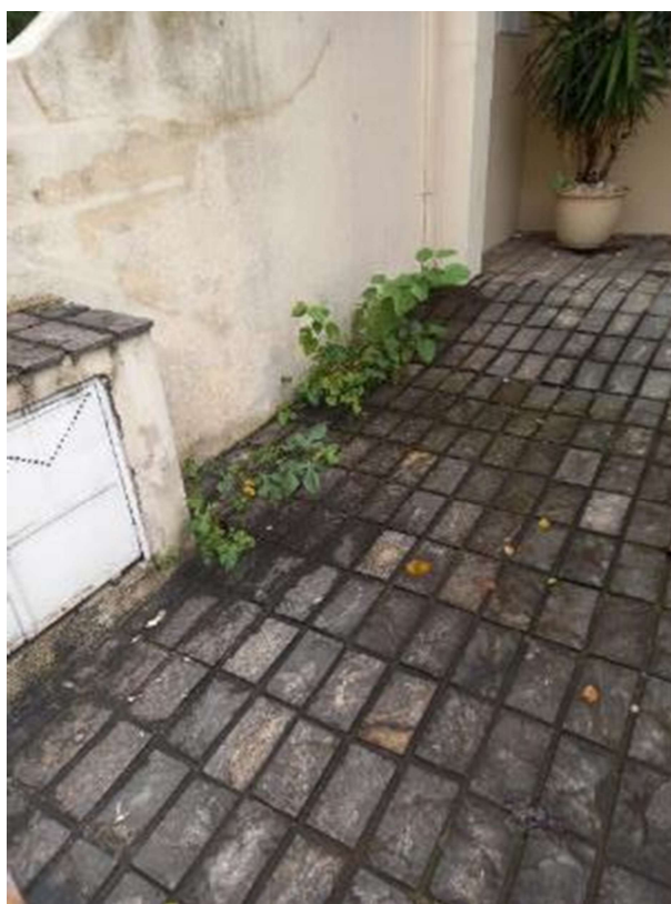
FOTO 24: Imagem de fissuras na lateral esquerda do imóvel
