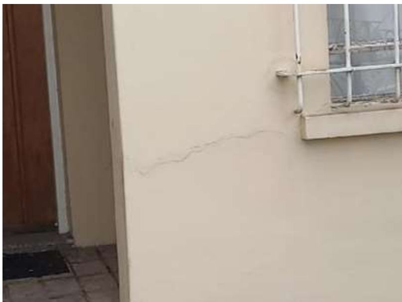
FOTO 23: Vista de fissuras na fachada do imóvel
