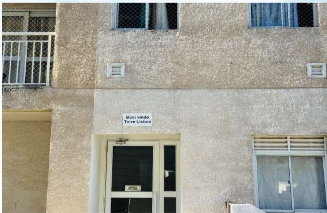
Fachada da torre 3 – Lisboa (2)
